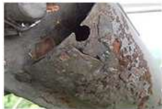
鉄塔 (部材発錆)
