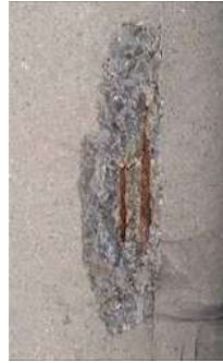
電柱 (コンクリート剥離)
