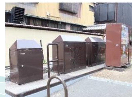
▲ 景観に配慮して設置された変圧器
