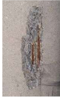
電柱 (コンクリート剥離)
