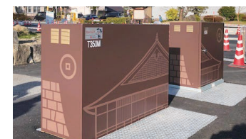
送配電設備を 活用した 広告事業 (関電サービス)
